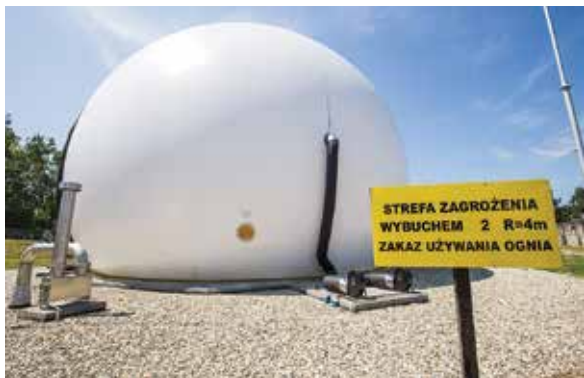
Balon do pozyskiwania gazów w oczyszczalni ścieków Aquy
