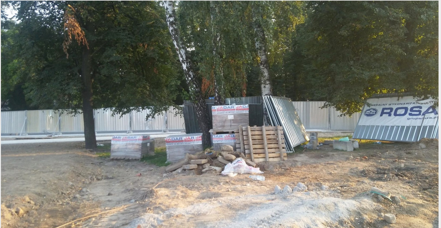
Składowanie materiałów budowlanych, ziemi, gruzu itp. w SOD
